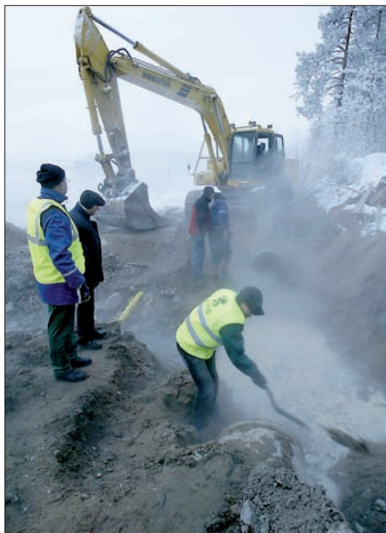
Jätevesiputkesta repeytyi noin puolen metrin mittainen pala.
